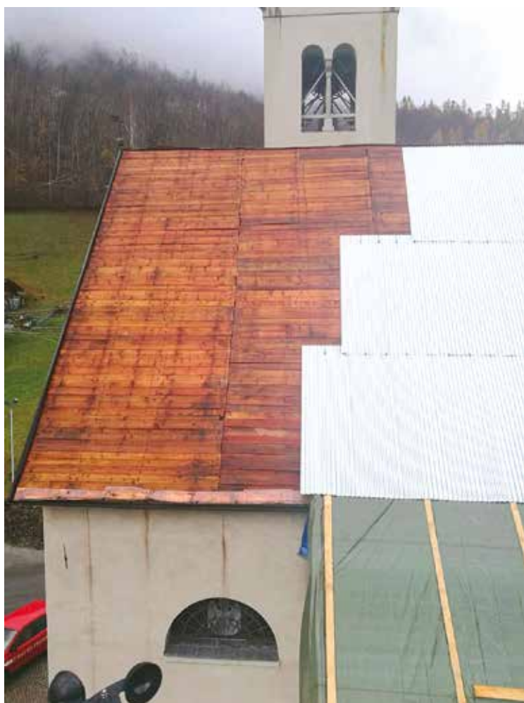
Una destinazione di fondi è andata per affrontare la spesa del rifacimento della copertura della chiesa di Tiser, danneggiata da Vaia a fine ottobre 2018.
